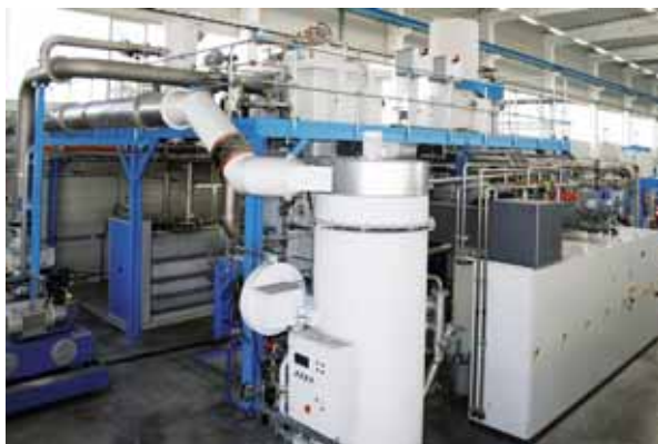
Bild 3 Blick in das FCT-Technikum mit für den Kombiprozess ausgelegten Hochtemperaturöfen
